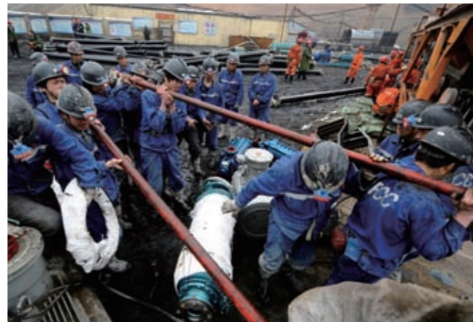
3月29日、ぬかるみの中でポンプを運び排水設備を取り付ける救助作業員（燕雁撮影）
